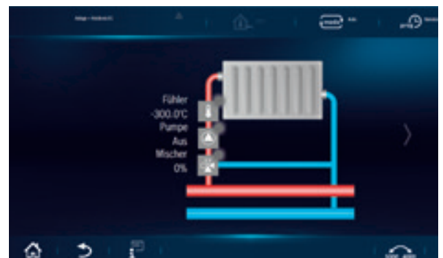
Monitoraggio e regolazione manuale del circuito di riscaldamento
